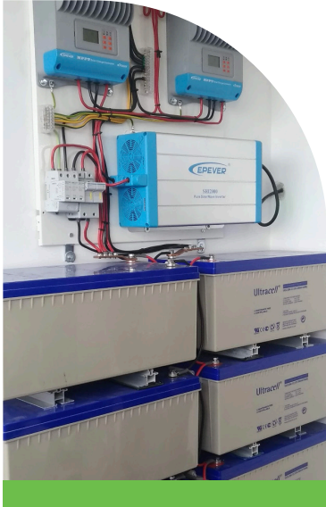
Inversor DC/AC Regulador de carga Baterias
